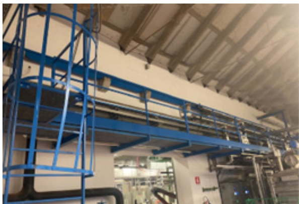
Figura 1 - Nuova attrezzatura installata per la manutenzione degli impianti tecnologici: passerella fissa di larghezza di 1.5 m, lunghezza di 30 metri (in sostituzione di scale doppie con altezza di 4 metri)
