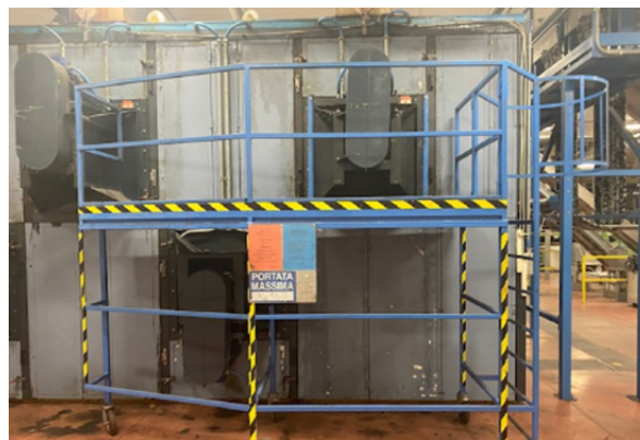
Figura 2 - Nuova attrezzatura installata per la manutenzione dei motori e dei cilindri dell'asciugatoio: trabattello conformato al macchinario (realizzate tipologie differenti di trabattelli in funzione della tipologia di macchinario); precedentemente l'addetto utilizzava una scala a castello o scala doppia
